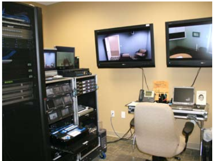
CAC/CJC Control Room
